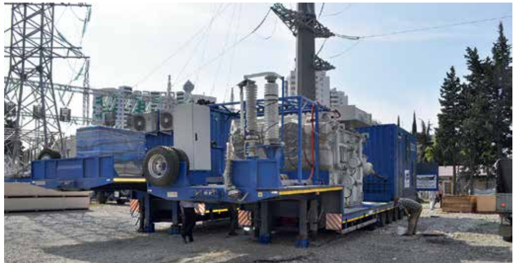
Площадка мобильной подстанции 25 МВА 110/10 (6) кВ
