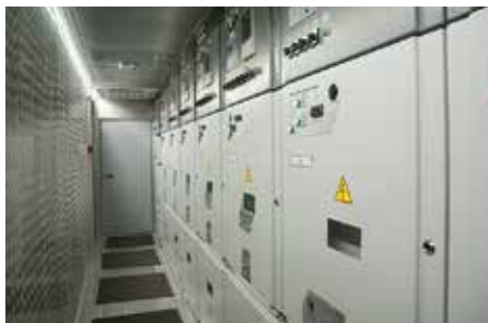
РУ 20 (10) кВ мобильного модульного исполнения
